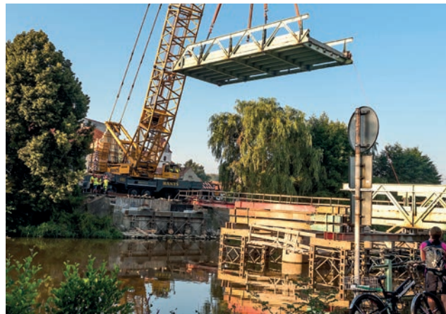
Ocelová konstrukce po sto letech dosloužila
